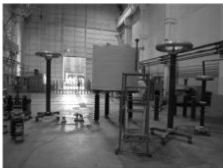
图 1 某 50 mH 电抗器匝间绝缘试验回路
